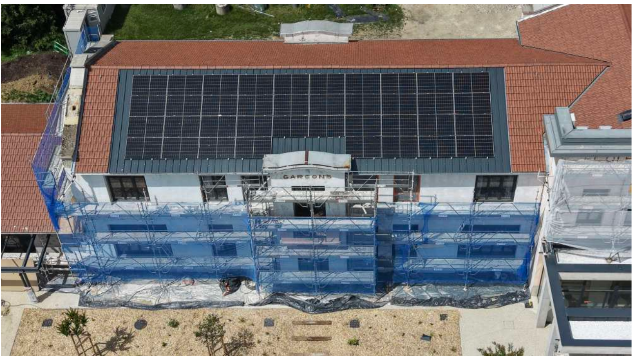
Vue de la toiture principale recouverte de ses panneaux solaires côté garçons
