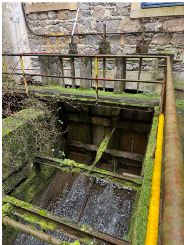
Entrée du canal et sa vanne de régulation
