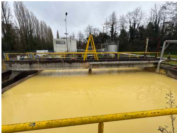
Bassin de Neutralisation du PH
