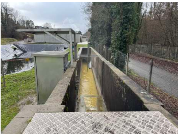
Bassin rectangulaire en béton des effluents
