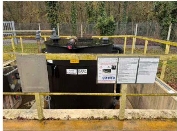
Cuve d'acide sulfurique
