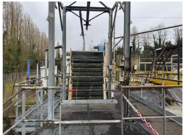
Dégrilleur Automatique (à Escalier)
