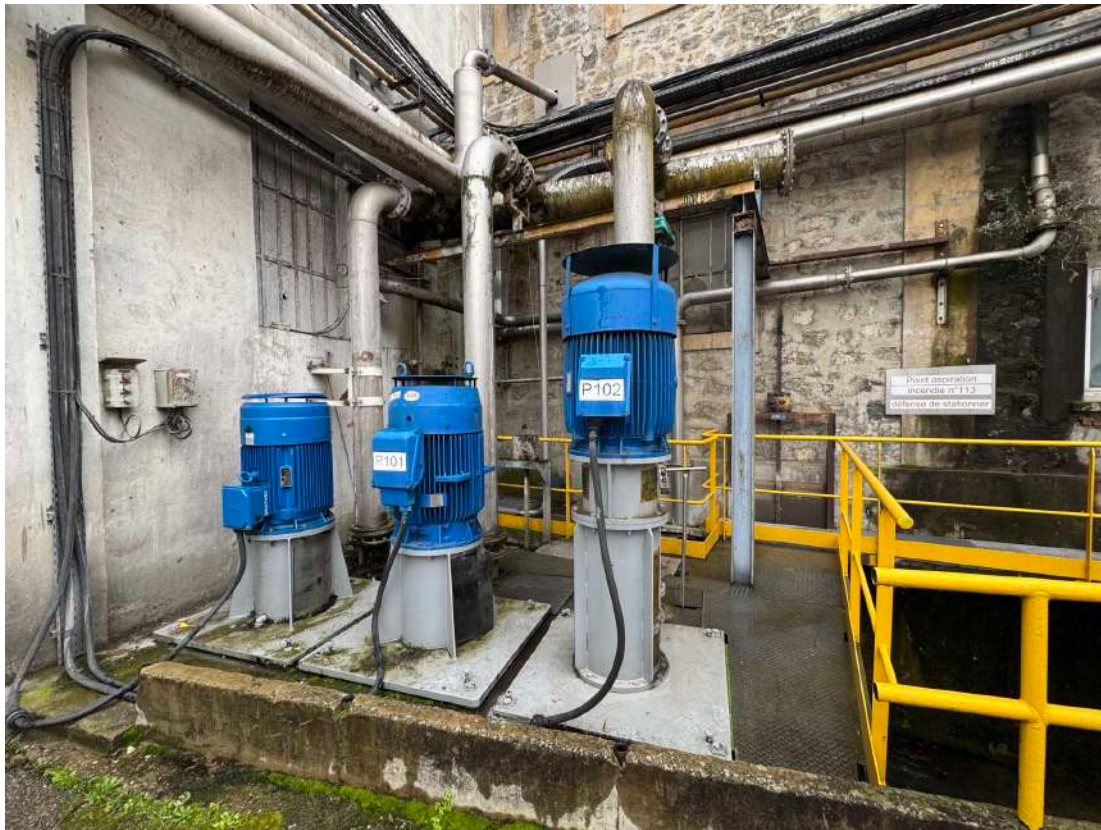
Installation des Pompes électriques au-dessus d'une fosse intermédiaire entre les puits et le château d'eau
