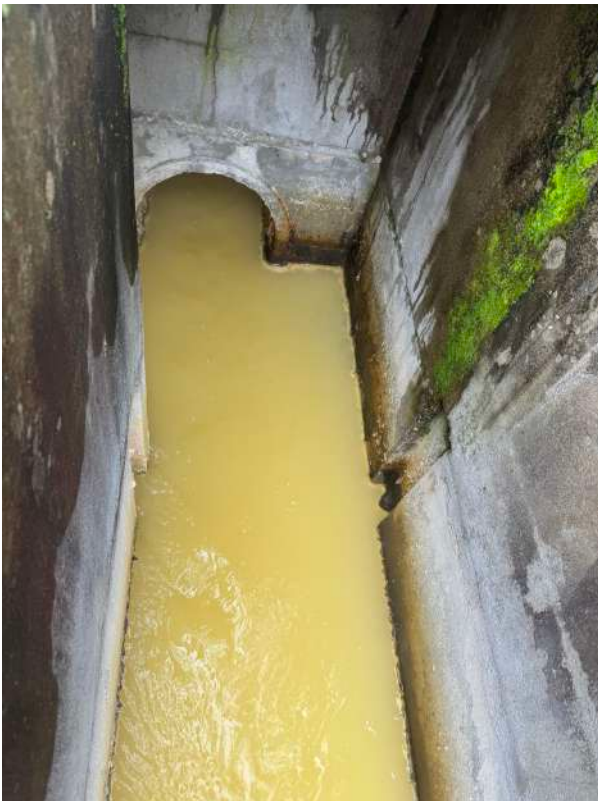
Entrée Bassin effluents
