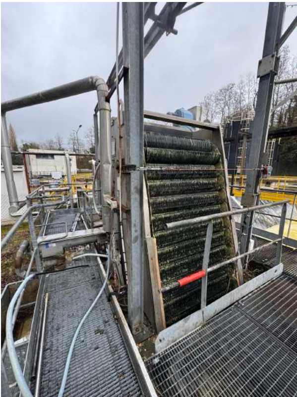
Dégrilleur Automatique (à Escalier)
