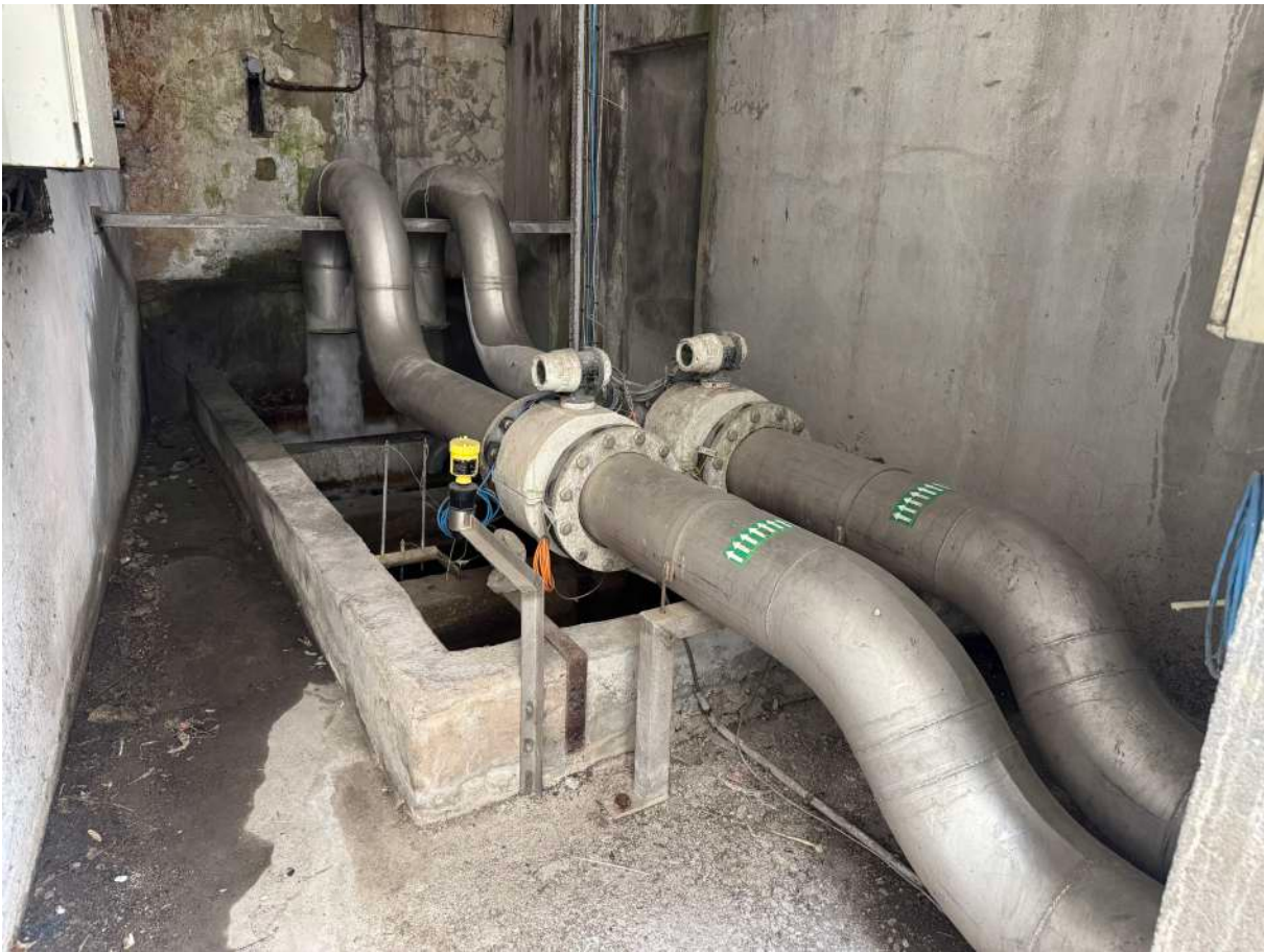
Réseau de tuyauteries entre les deux puits et la fosse de relevage
