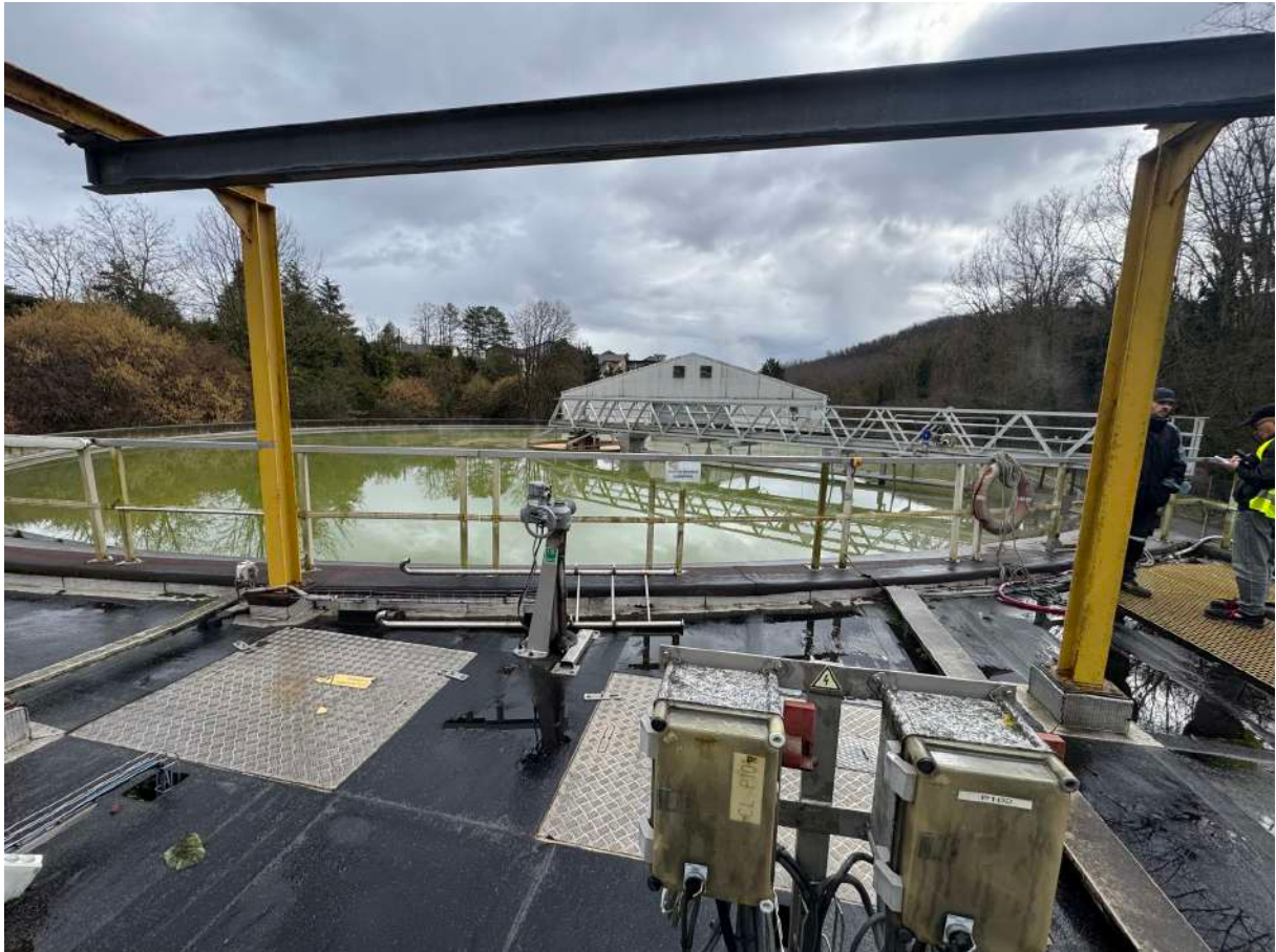
Boîtiers de commande pilotant les pompes de recirculation des boues
