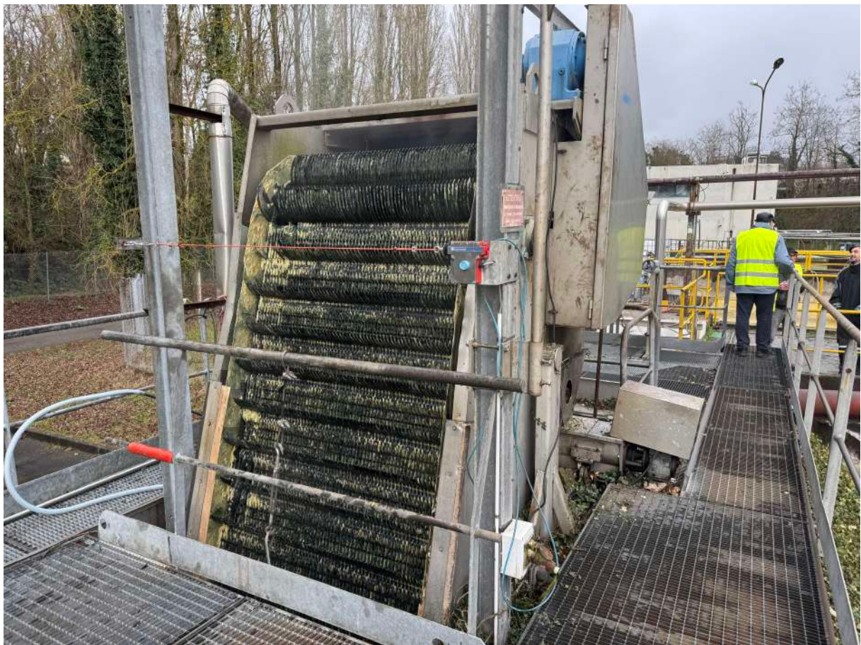
Dégrilleur avec ces grilles de filtration et barreaux pour piéger les gros solides
