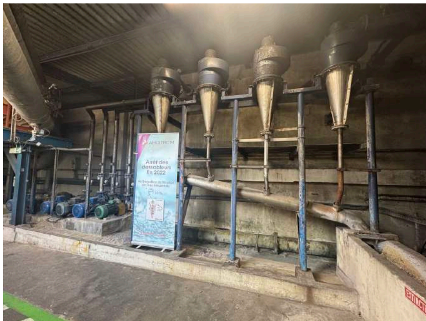
batterie de hydrocyclones (ou épurateurs centrifuges)
