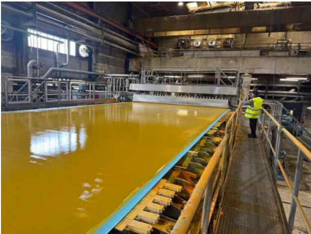
Contrôle de la feuille en formation
