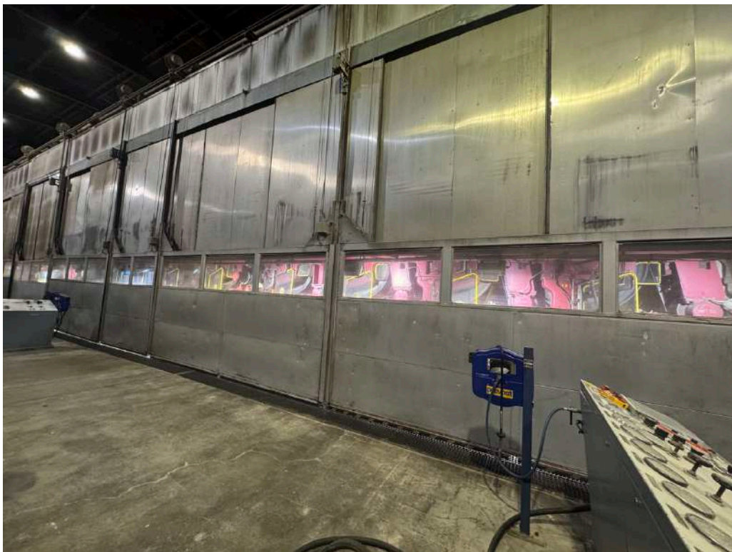
Première batterie de séchage avec cylindres rotatifs
