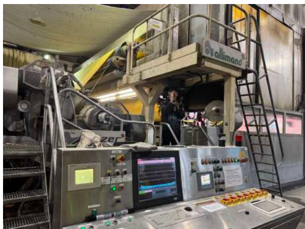
Zone de transfert entre pré-sécherie et les 2 presses d'enduction du sizer
